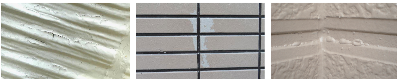
厚塗りによるひび割れ
